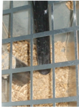
Fig. 64 - Reiniging van de voorraadbak en transportschroef
