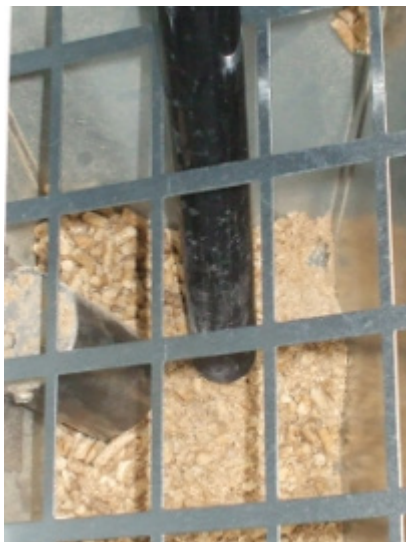
Fig. 31 - Nettoyage réservoir et vis sans fin
