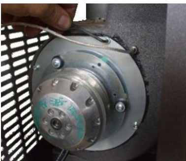
Fig. 35 - Pulizia aspiratore fumi: fase 1
